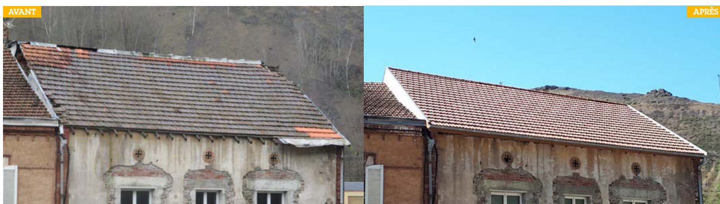
À Fontvergnès, réparation de la cheminée tombée sur la toiture voisine et des éléments de toiture tombés dans la rue
